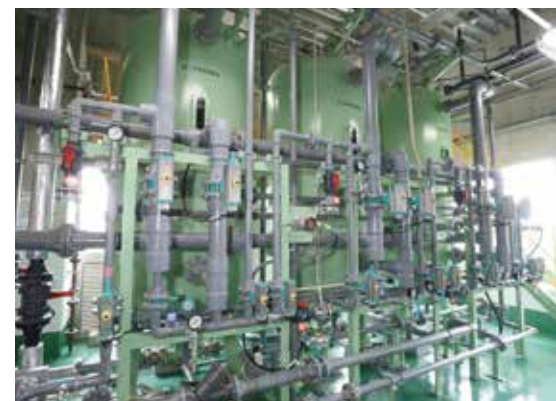
■水処理活性炭吸着塔
