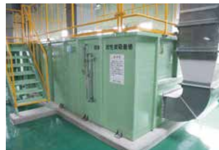
■脱臭活性炭吸着塔
