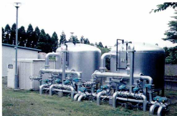
急速ろ過装置
